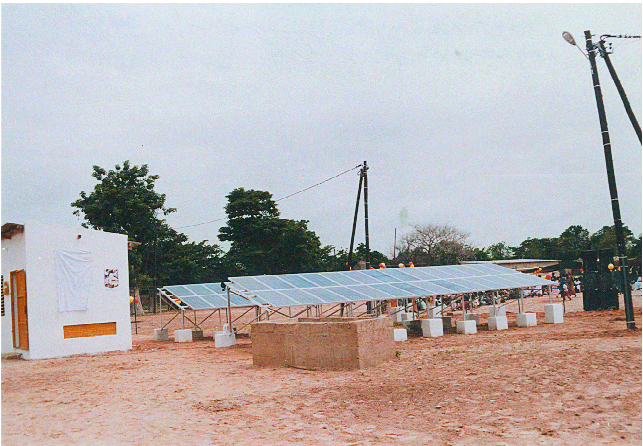
Centrale solaire de Ndélé (Guinée-Bissau)
